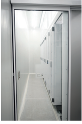
Sıcak Koridor Kapama Sistemi
