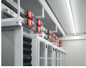
Busbar Güç Dağıtımı
